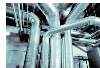
分岐配管の風量調整
