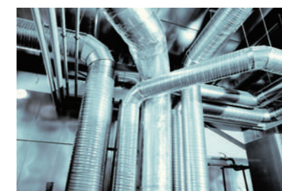
分岐配管の風量調整
