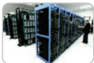
データセンター の環境管理
