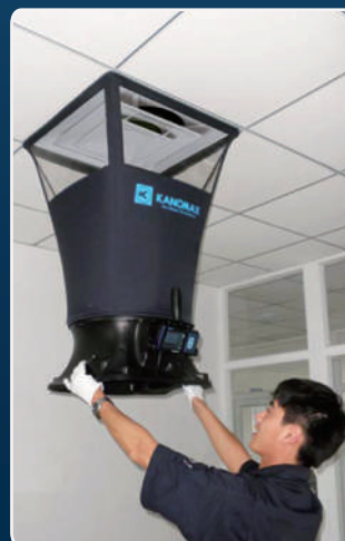
空調機器の点検・調整に
