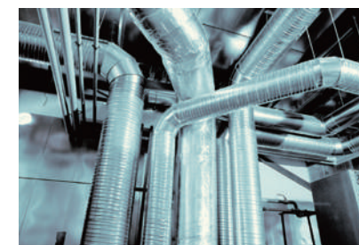
分岐配管の風量調整
