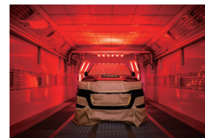
塗装ブースの風速・温度管理
